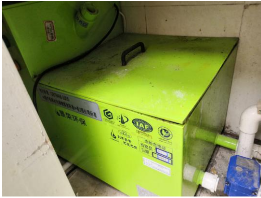
医疗废水处理设施
