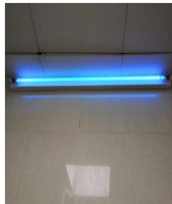
项目已安装紫外消毒灯管
