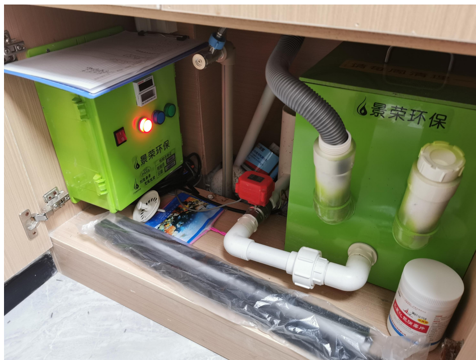
已安装医疗废水处理设施
