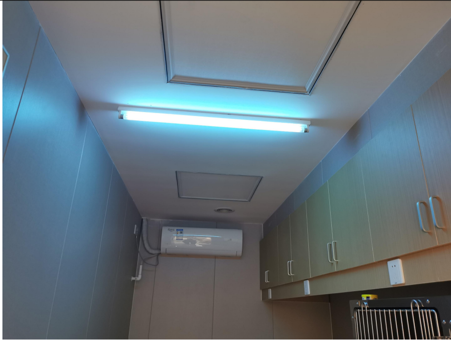
项目已安装紫外消毒灯管
