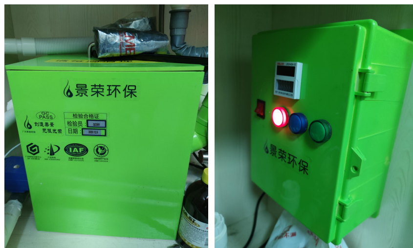
项目已安装医疗废水处理设施
