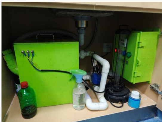
已安装医疗废水处理设施
