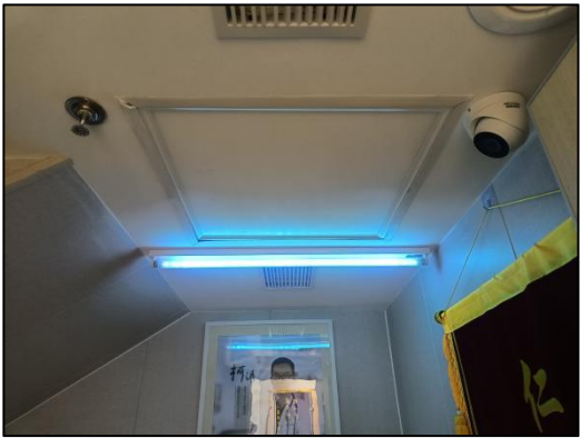
项目已安装紫外消毒灯管
