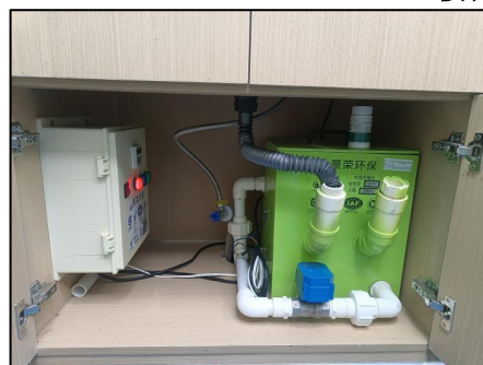
2楼手术室内污水处理设施
