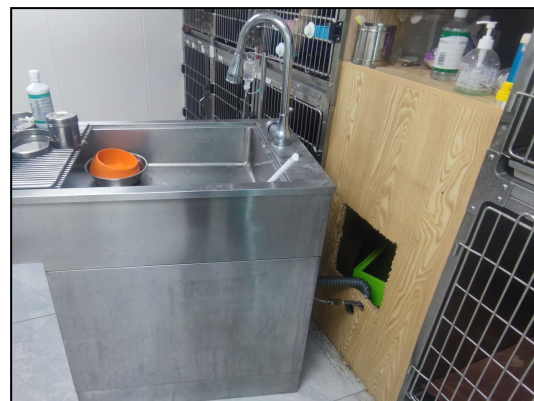
位于 2 层中央处置区废水处理设备 2#
