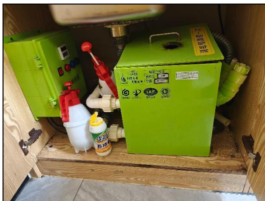
位于 1 层化验室废水处理设备 1#
