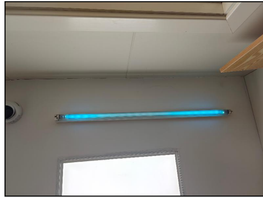
项目已安装紫外消毒灯管
