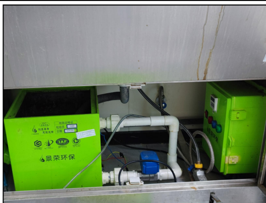
位于2层手术准备间废水处理设备3#
